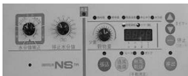
〈S型シートスイッチ制御盤〉
